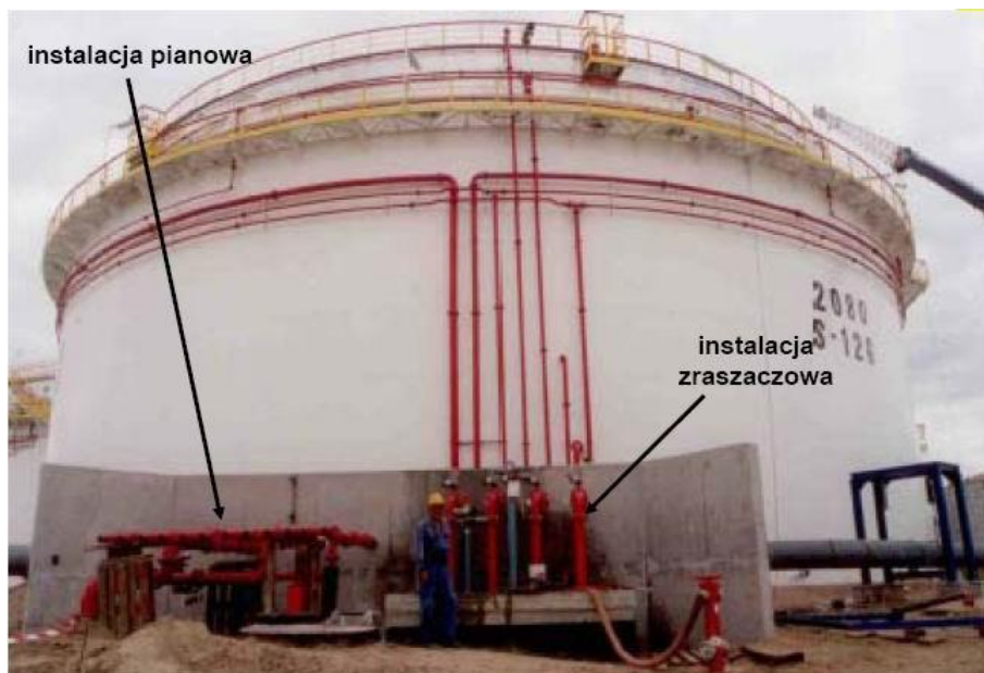
Rys. 1a. Stanowisko ppoż przy zbiorniku. Po lewej stronie instalacja pianowa z przyłączami dla wozów strażackich. Po prawej stronie instalacja zraszaczowa.
