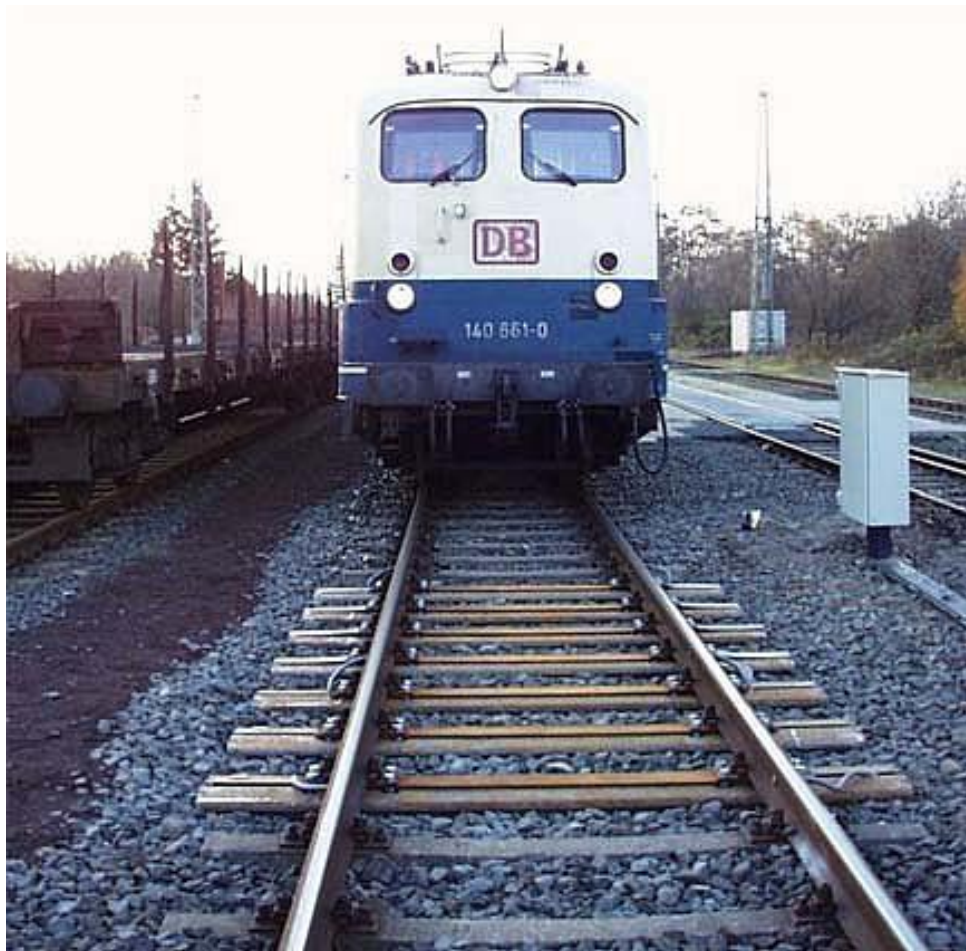
Zdj. Waga bezpomostowa – czujniki tensometryczne wbudowane w podkłady
