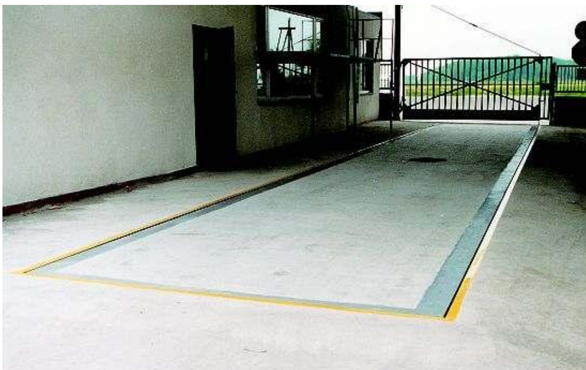
Zdj. Waga samochodowa pomostowa zagłębiona
